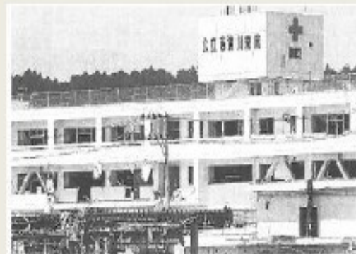
公立三津川病院の建物は外壁や内部が崩壊した。被害が大きく、移転して再開した（6月25日、日城川市二宮町）
