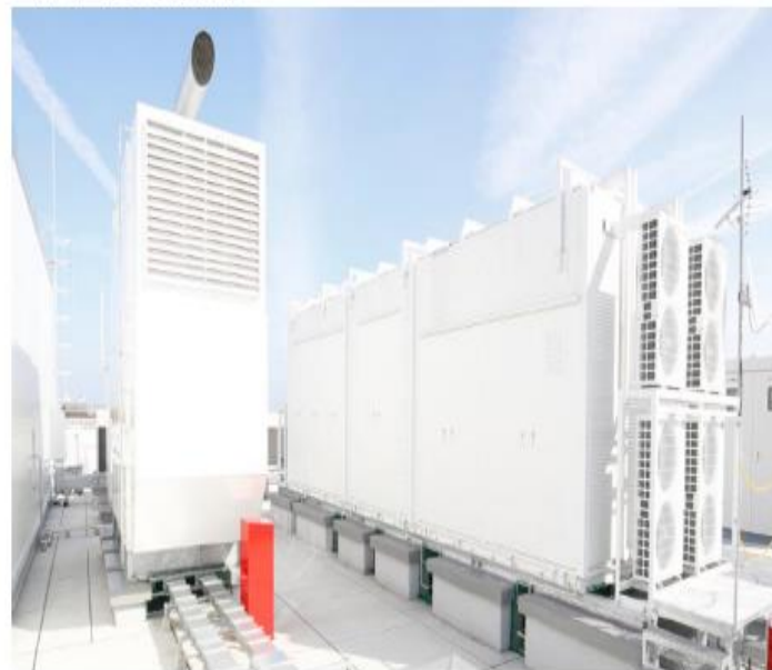
自家発電設備
